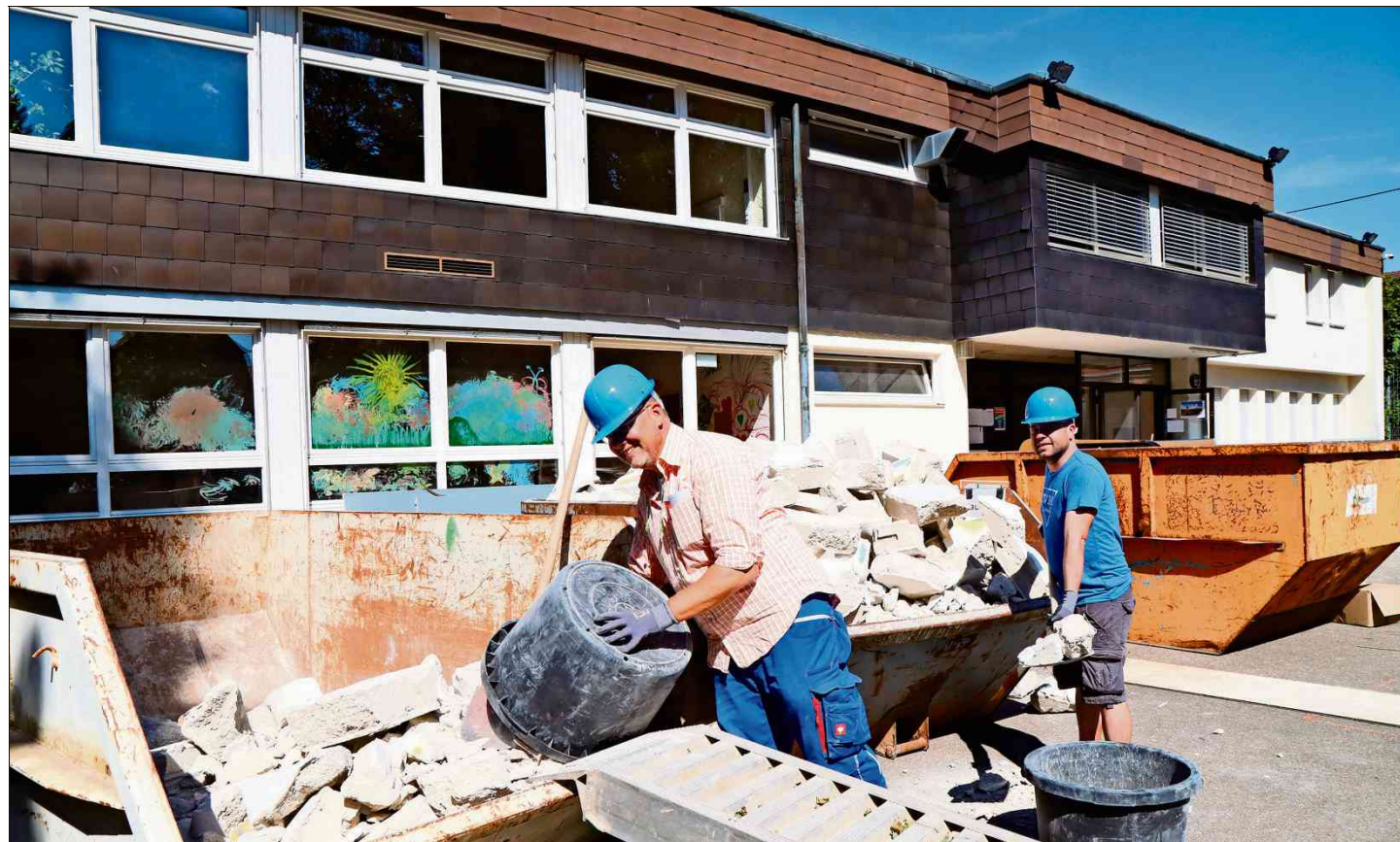
Staubige Chefs: Jan Uwe Berner und Hannes Laipple befüllen die Container mit Abbruchmaterial.
